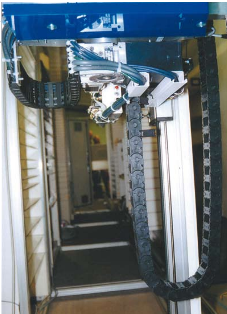
Des fibres optiques sont utilisées depuis huit ans pour la manipulation rapide dans plus de 300 entrepôts de médicaments automatisés réalisés par la société Mach4
