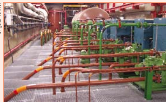
Salle des pompes
