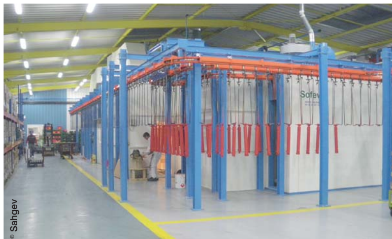
L'imposante chaîne de peinture et de traitement de surface, qui vient d'être inaugurée pour un coût global de 1,2 million d'euros, pourra traiter quelque 4.000 vérins par jour dont la tenue en brouillard salin sera garantie plus de 800 heures !
